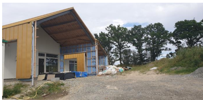
Côté droit, préau bibliothèque devant et préau accueil de loisirs derrière, donnant côté jardin.
